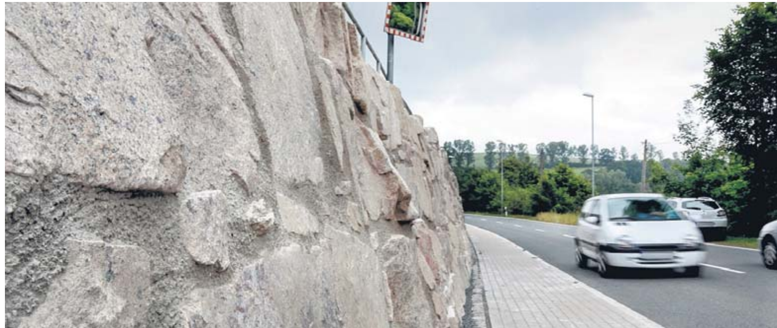
Die Stützmauer in Dittmannsdorf an der B 180 in Richtung Flöha ist nachträglich mit Kalkmörtel verfugt worden.
